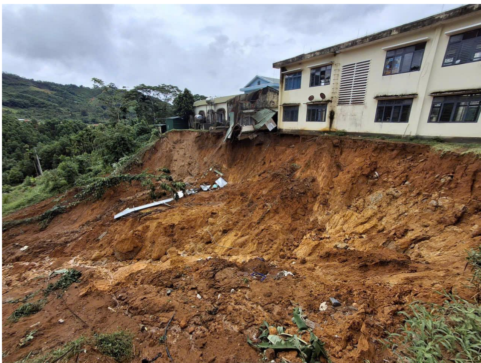
(Hình 1.1 Hiện trạng sạt lở tại Trường PTDTBT TH&THCS Sơn Long)
