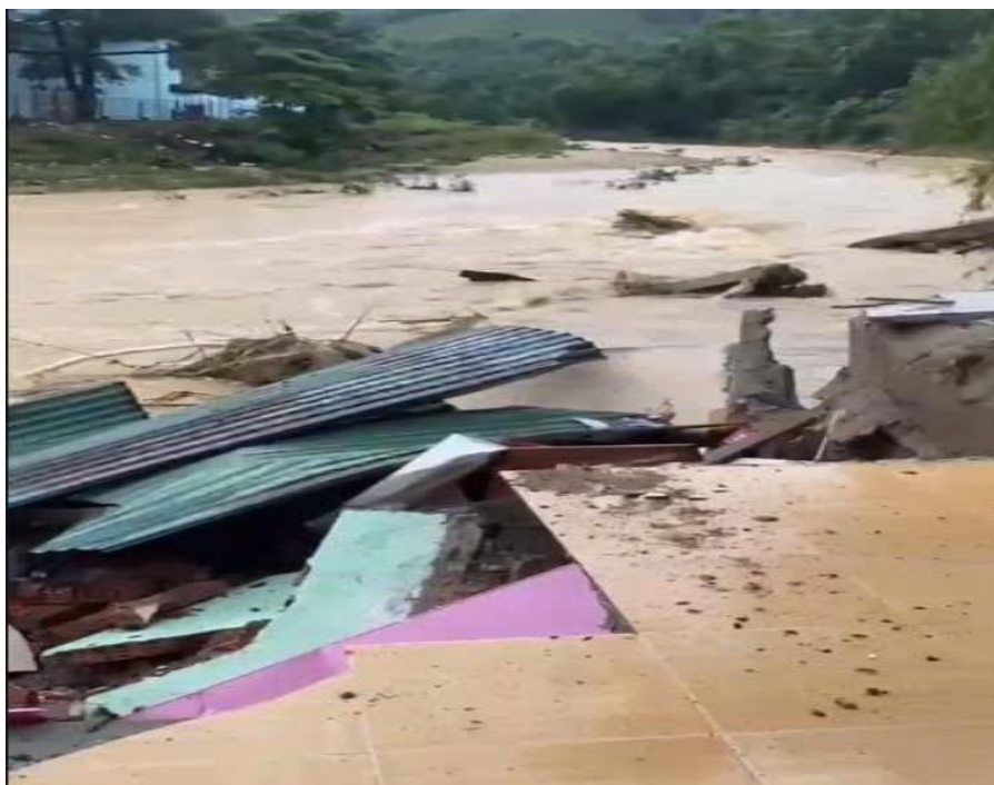
(Hình 3.2 Hiện trạng sạt lở nhà ông Đinh Kiều Long)
