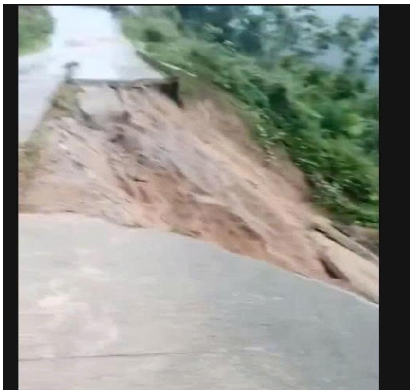
(Hình 4.1 Hiện trạng Sụt gãy đường Huyện Đội- Đăk Trên)
