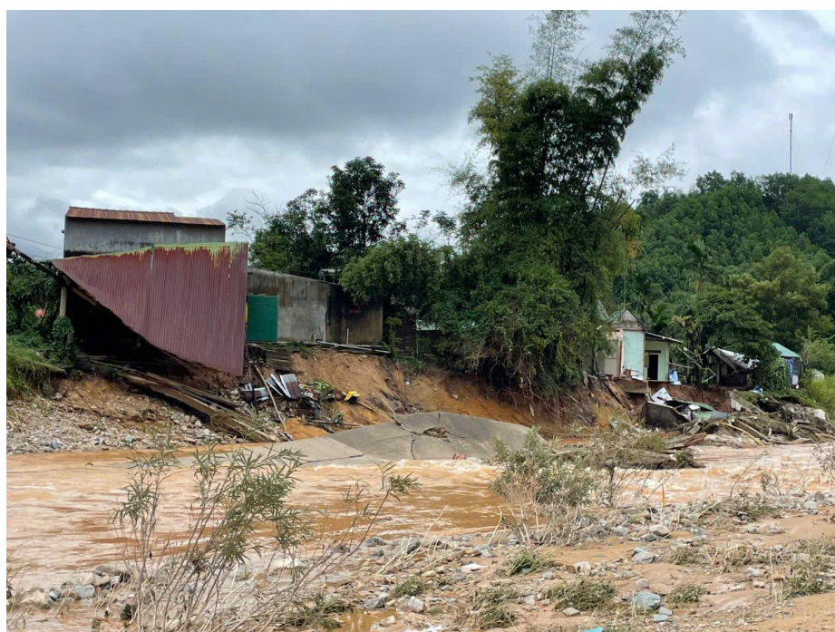
(Hình 3.1 Hiện trạng sạt lở bờ suối Huy Măng đoạn nhà ông Đinh Kiều Long)
